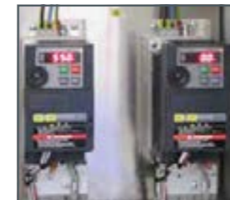
Convertidores de frecuencia para controlar las bombas
