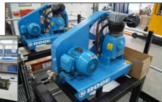
Estación de aire comprimido
