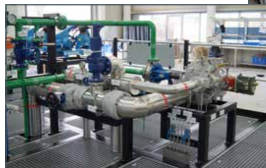
Estación de bombeo auxiliar accionada por vapor
