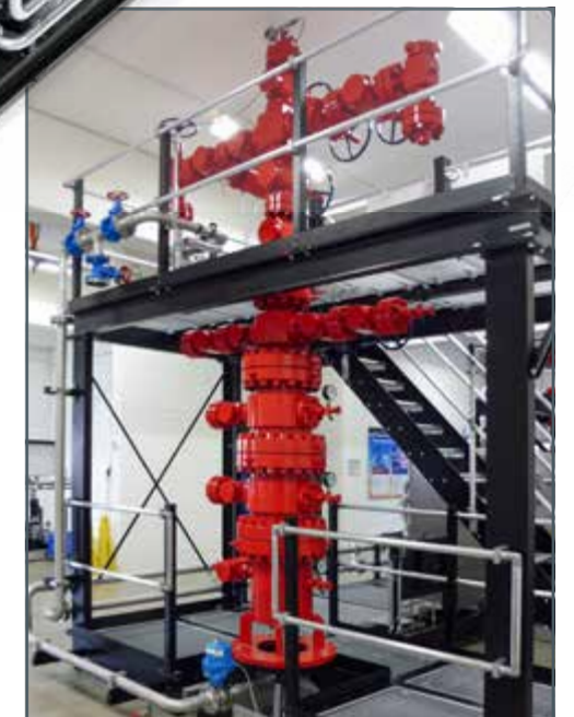
Boca de pozo y árbol de Navidad ("Xmas tree")
