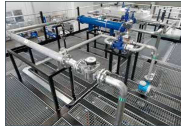
Reactor térmico con sistema de inyección química
