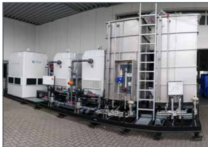
Torres de refrigeración por vía húmeda y depósitos de reserva de agua de proceso y etilenglicol en el exterior
