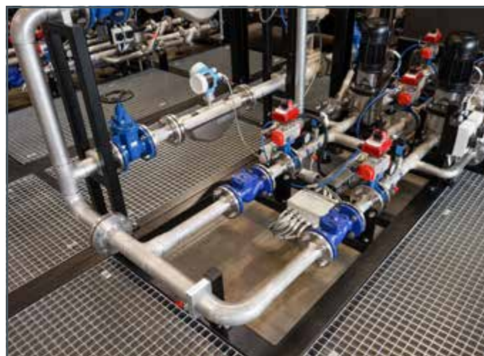
Proceso circular: bombas redundantes y caudalímetros Coriolis
