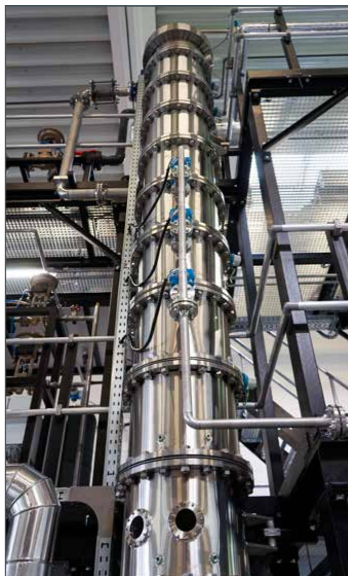
Proceso de destilación: columna de rectificación
