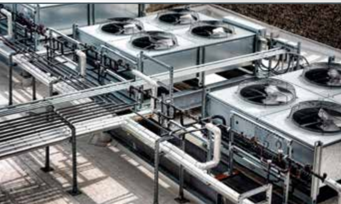
Condensador en una red de refrigerante
