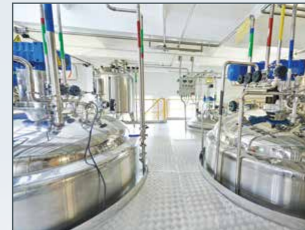
Depósito de agitación a escala industrial
