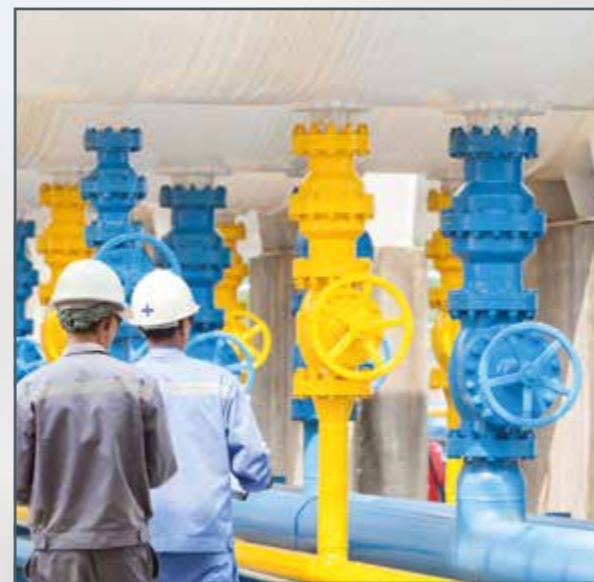
Robinerías de una planta de distribución a escala industrial
