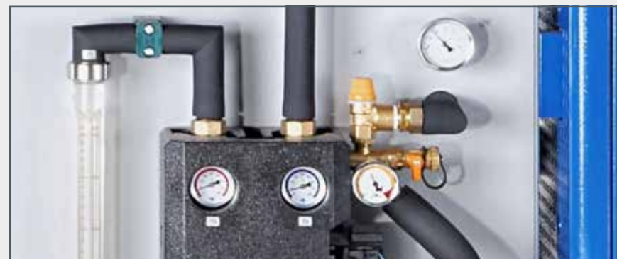
La estación del circuito solar contiene una bomba de circulación y componentes esenciales para un funcionamiento seguro.
