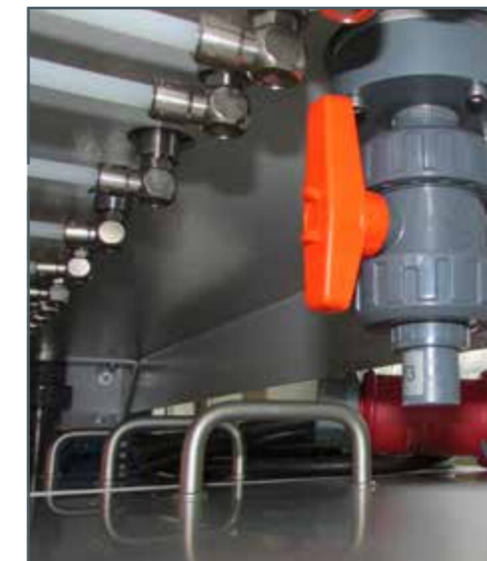
Puntos de medición de presión y grifo de descarga
