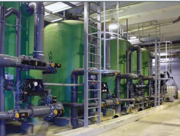
Adsorbedores con flujo de paso continuo en una planta de tratamiento de aguas
