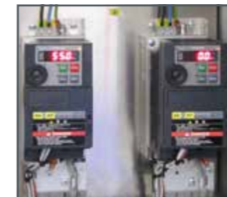
Convertidores de frecuencia para controlar las bombas
