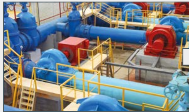
Instalación de bombeo
