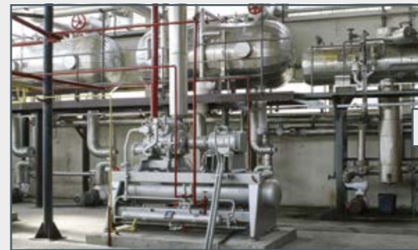
Instalación de generación de aire comprimido en la industria
