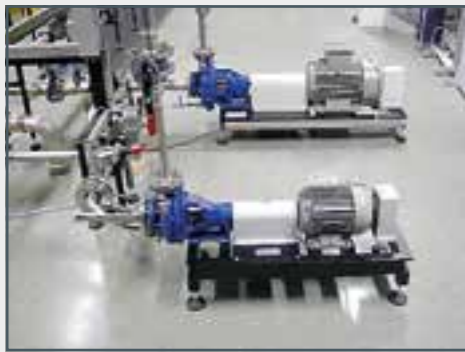
Estación de bombeo de la HM124
