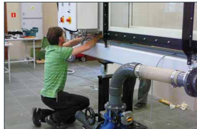
Últimos trabajos en la instalación eléctrica (izquierda). Después se orienta el depósito de agua y se conecta con el sistema de tuberías (derecha).
