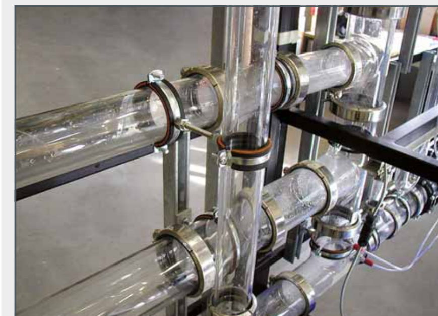
Tuberías y robineterías de vidrio
