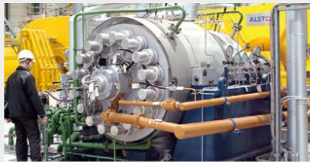
Bomba centrífuga de una central energética
