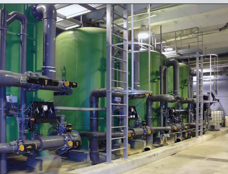
Adsorbedores con flujo de paso continuo en una planta de tratamiento de aguas
