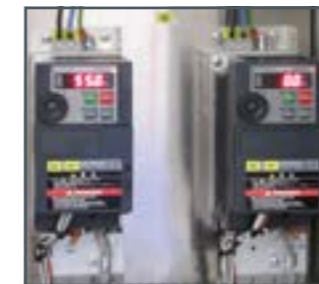
Convertidores de frecuencia para controlar las bombas
